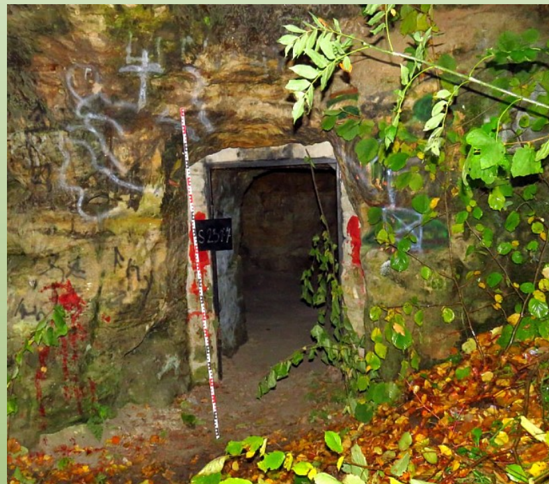
Poškození portálu štoly v Lindavě
